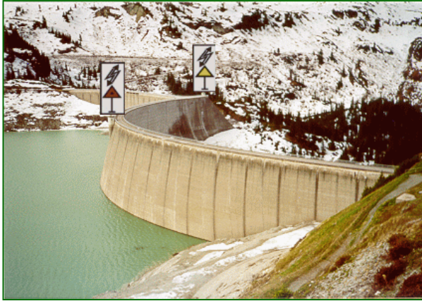
Рис. 7: Инсталляция системы GOCA: расположение пунктов объекта x_O(t) на дамбе Копис, Австрия.
